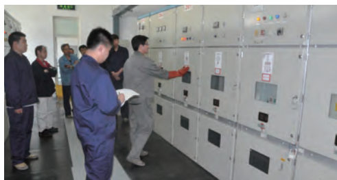
中汽中心物业服务部举行35kV变电站反事故应急演练
